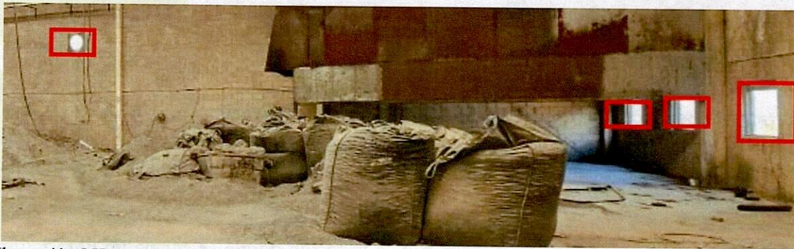
Ilustración 5. Huecos sin protección
